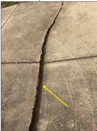
Uneven trip hazard
